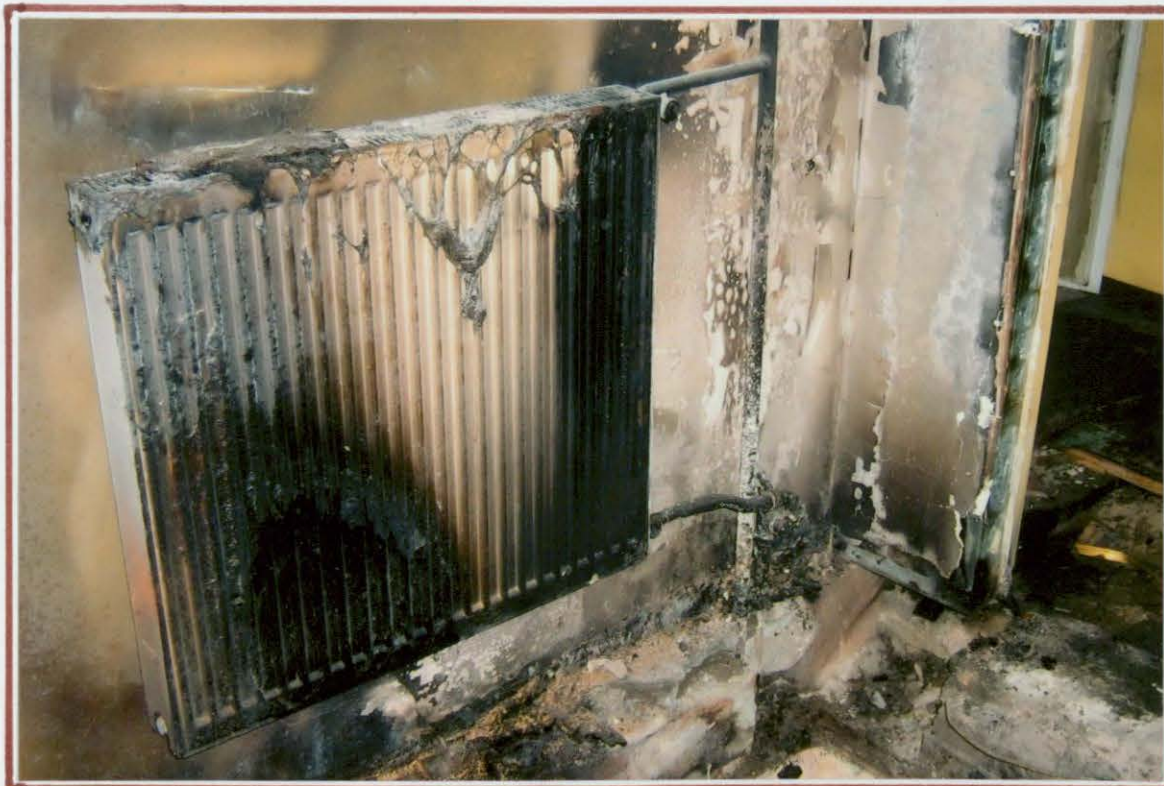
Zniszczenia po pożarze
