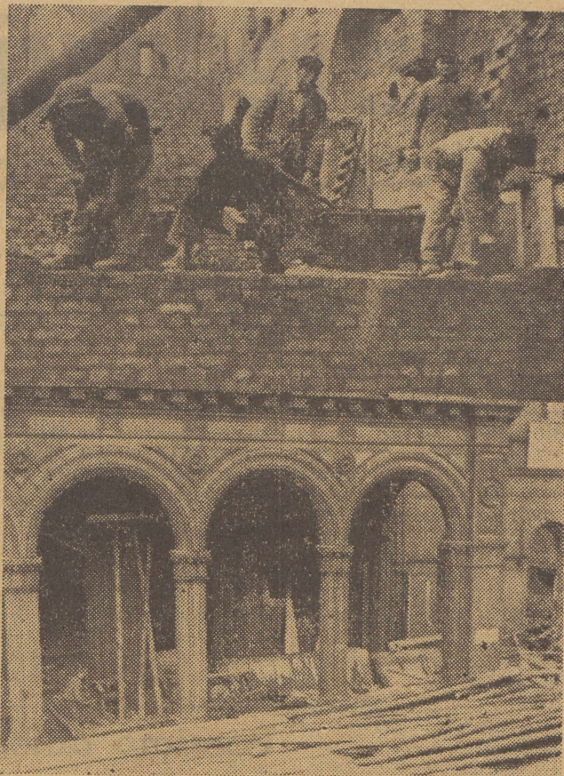
Dworzec Poznański, dotychczas zrażał swym „prusackim” zewnętrzny wyglądem, ciasnotą pomieszczeń, tunelami, które w czasie ulew tonęły w wodzie.
