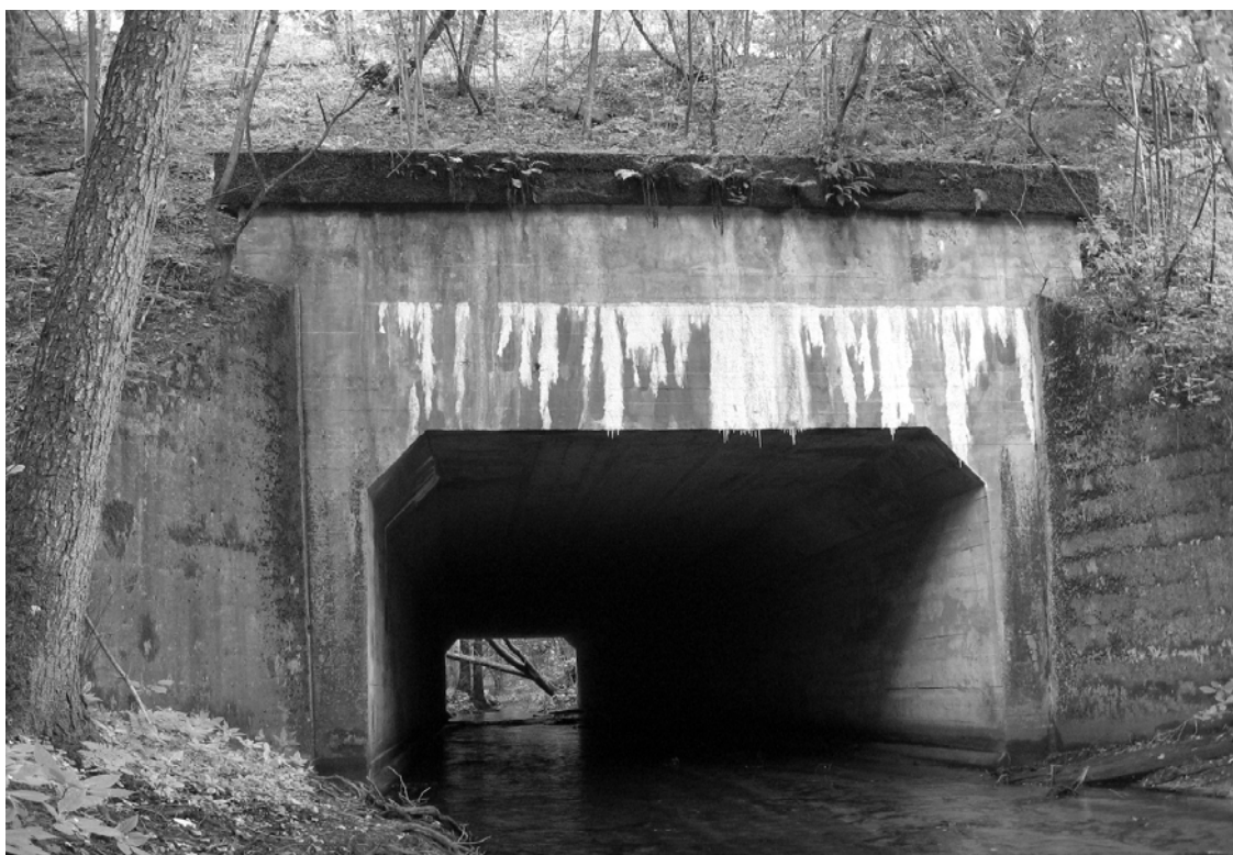
Żelbetowy przepust kolei budowlanej o długości 40 m na Strudze Jeziornej, fot. R. Michalak 2008
