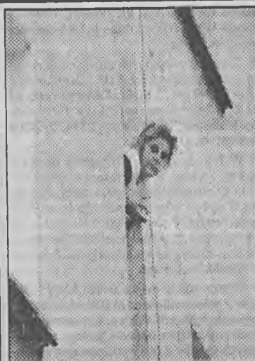
Świebodzin, ulica Watowa. Szczelina w ścianie? Dziwny widok, prawda...? Fot. Waldemar Szmidt
