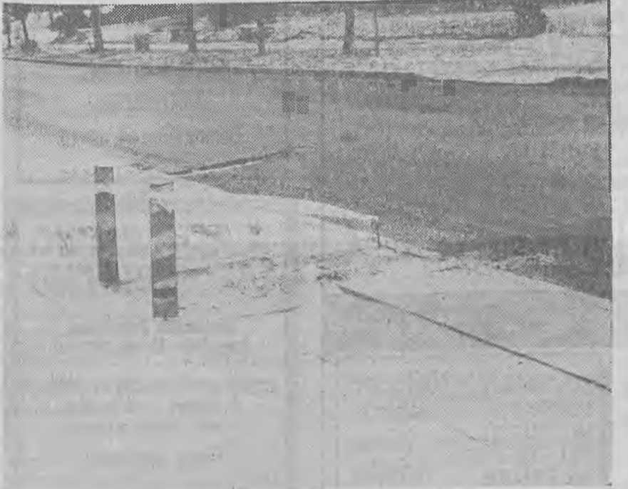
Chodnik przy ul. Ogrodowej. Gdyby tak wszyscy wykonawcy robót drogowych czy „chodnikowych” pamiętali o właściwym ich oznakowaniu. Fot. Krzysztof Mężyński
