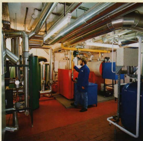
Nowoczesna kotłownia wykorzystująca gaz ziemny.
